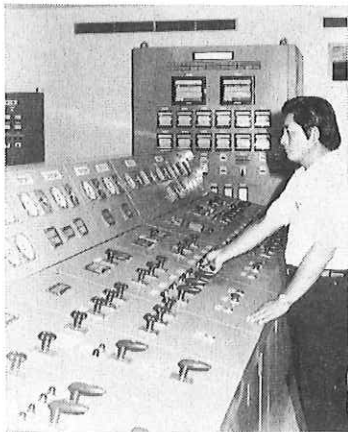
写真271 水道事業所機械室（岩中）
